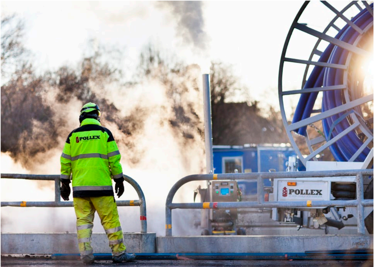
Aufstellen eines egeliners mit Wasserdampf Resizing of an egeliner® using hot steam
